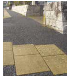
摩耗した点字ブロック
