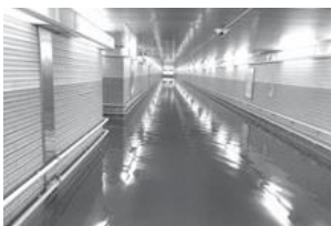
浸水した新発田駅地下道
