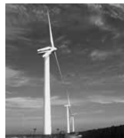
藤塚浜の風力発電施設
